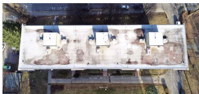
Vznik kaluží na nové střeše kvůli nedostatečnému vypádávání
